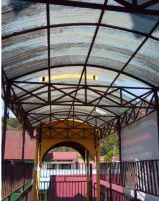
Gambar L.7: Kondisi kanopi yang sudah rusak
