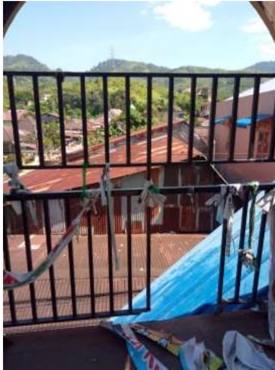
Gambar L.3: Kondisi pegangan jembatan yang sudah rusak
