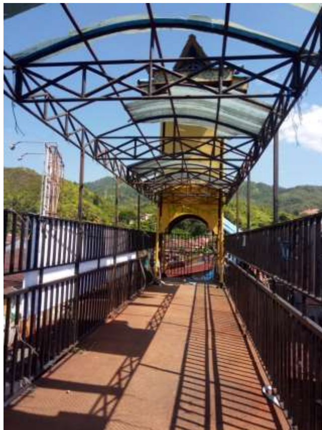
Gambar L.4: Kondisi kanopi yang sudah rusak
