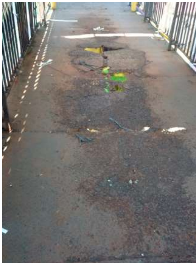
Gambar L.8: Kondisi plat baja jembatan yang sudah rusak
