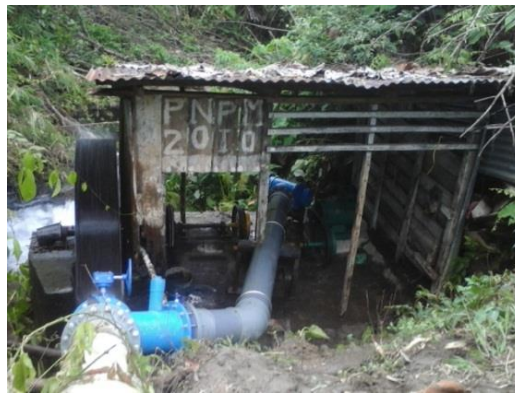
Gambar 3.1 Pembangkit Listrik Tenaga Mikro Hidro (PLTMH) di Dusun Bintang Asih.
