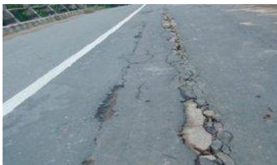
Gambar 2.7: Retak sambungan pelebaran jalan ( Widening Cracks ) (SOP PUPR 2016).
