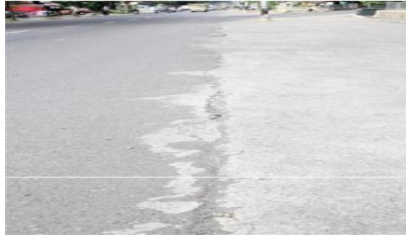
Gambar 2.5: Retak sambungan bahu dan perkerasan ( Edge Joint Cracks ) (SOP PUPR 2016).
