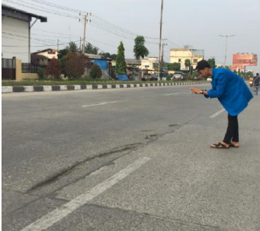
Gambar L.2: Identifikasi kerusakan Jalan Cemara.
