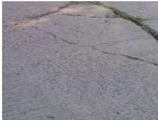
Gambar 3.8: Jalan beton hancur.
