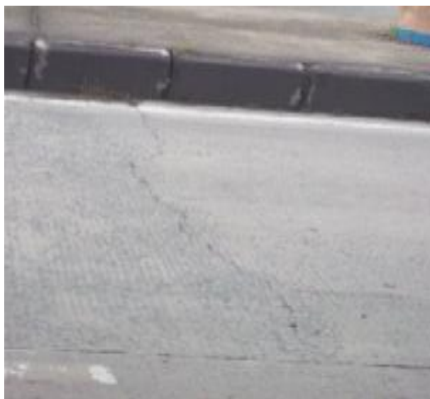
Gambar 3.4: Jalan retak setempat.
