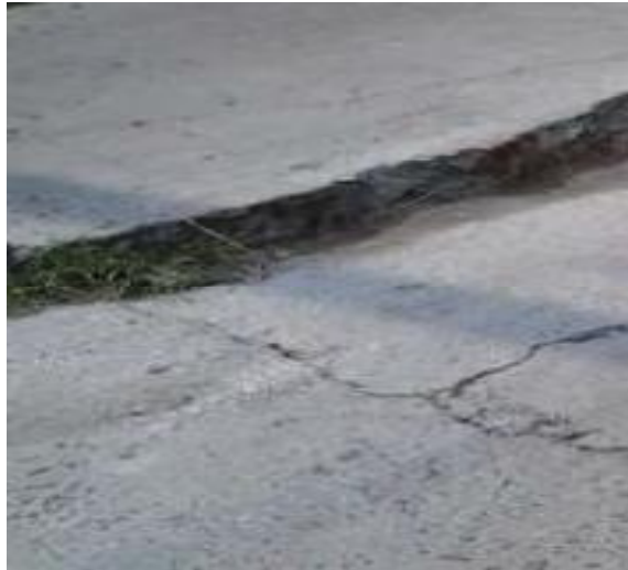
Gambar 3.5: Patahan pada jalan beton.
