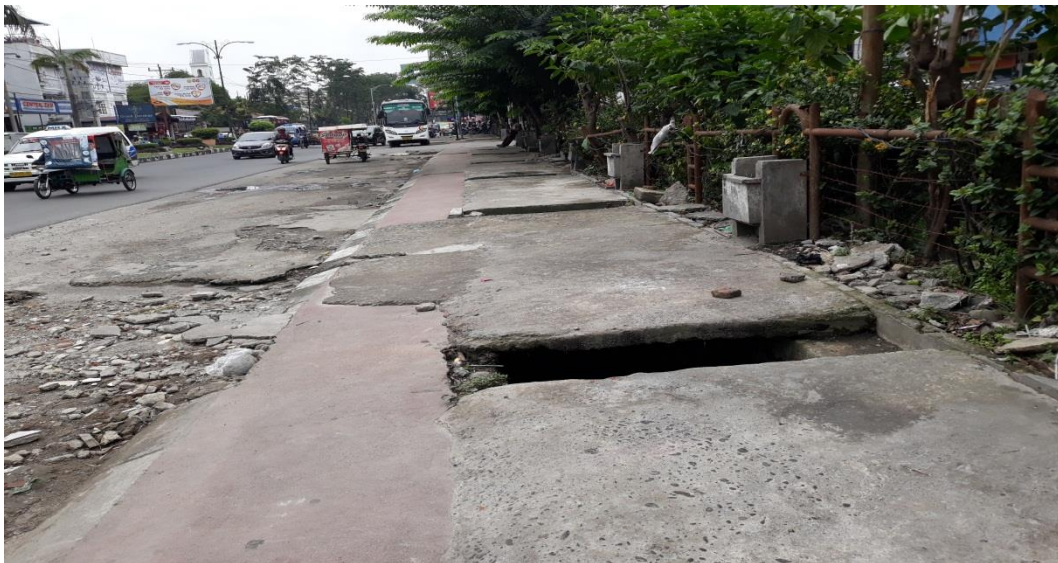
Gambar L10: Kondisi saluran drainase pada saat ini.
