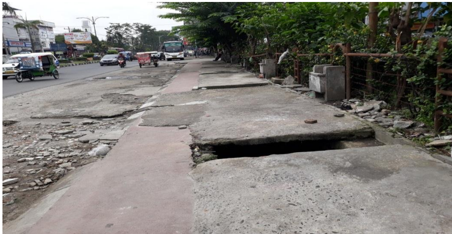
Gambar 3.4: Gambar kondisi saluran Drainase di Jalan Kapten Muslim, Medan pada sisi kanan.
