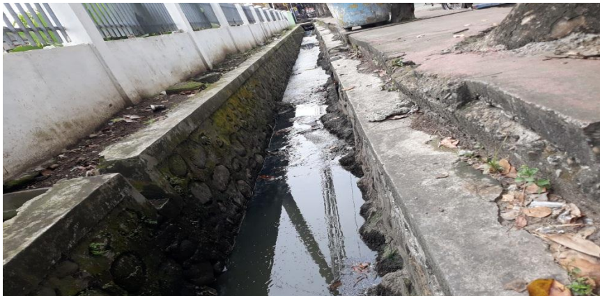
Gambar 3.3: Gambar kondisi saluran Drainase di Jalan Kapten Muslim, Medan pada sisi kiri.
