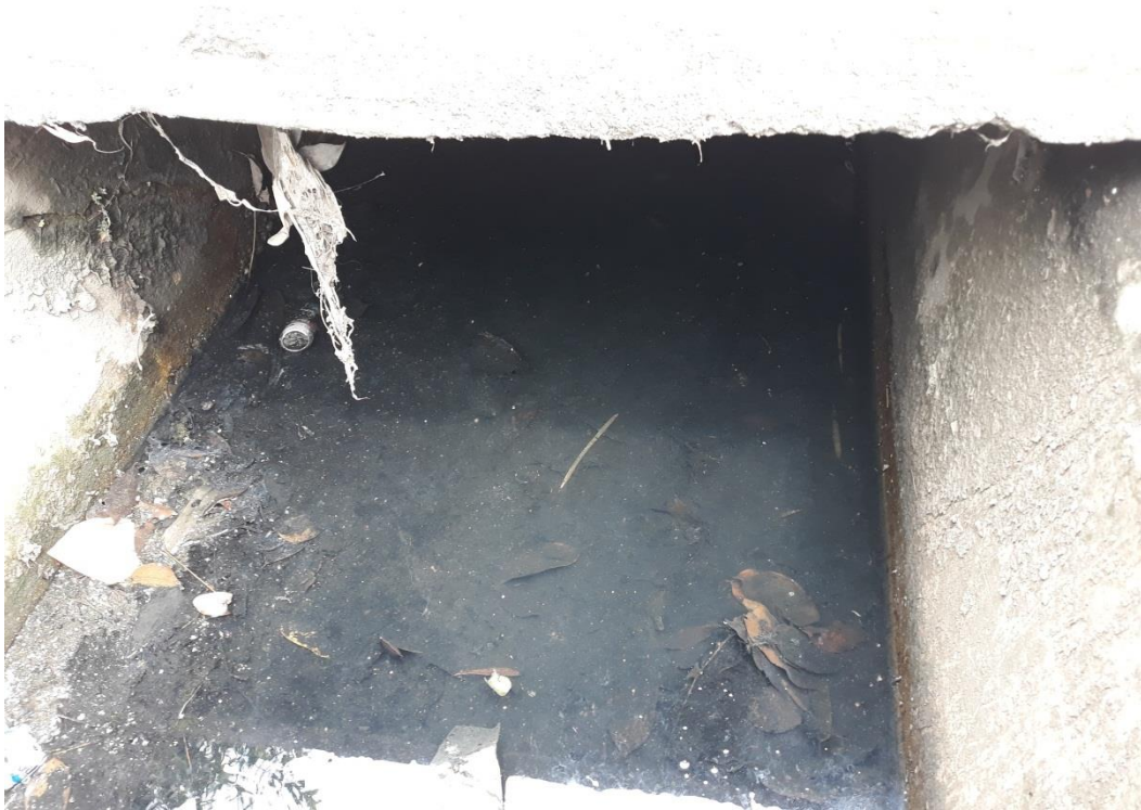
Gambar L4: Kondisi terkini saluran drainase di Jalan kapten Muslim.
