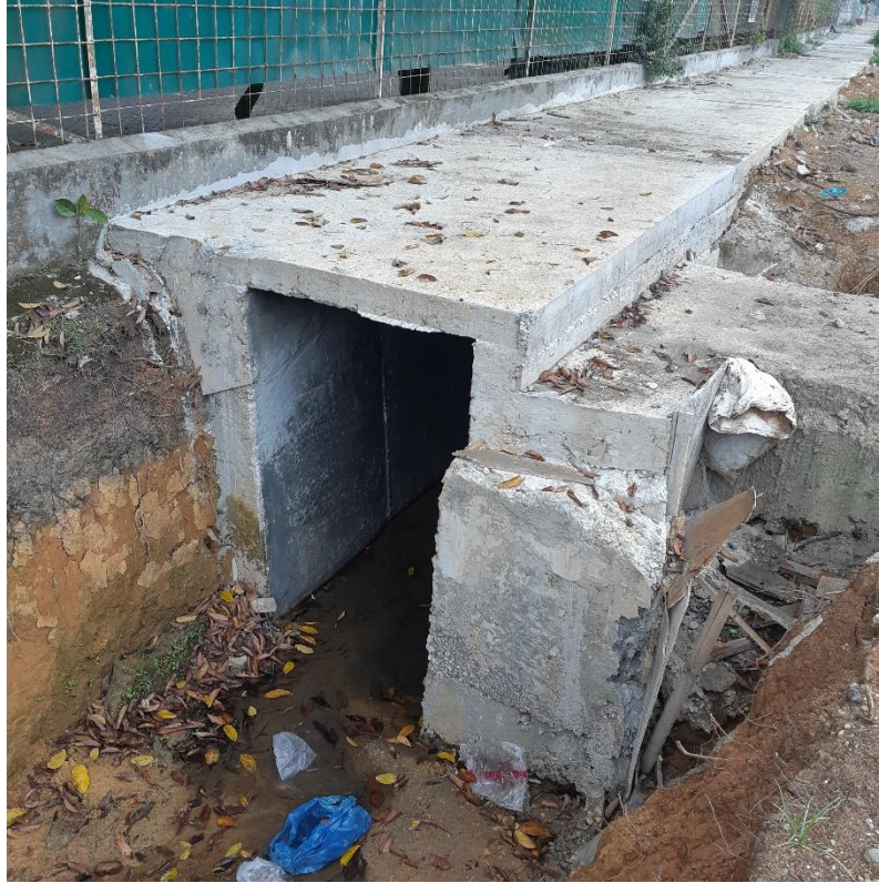
Gambar L.3: Kondisi saluran drainase sebelah kiri.
