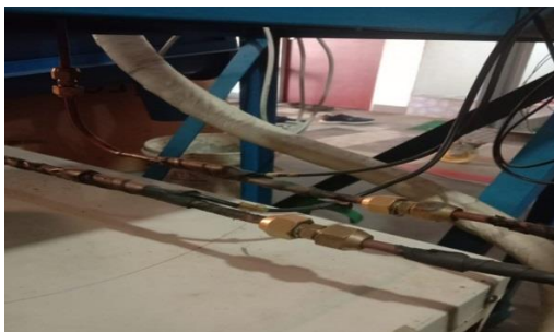
Gambar 4.29. Pipa Keluar Kompresor
