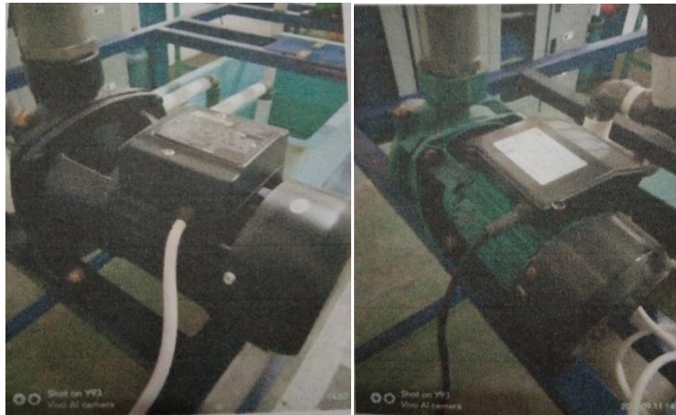
Gambar 4.2. Pompa 1 Dan Pompa 2
