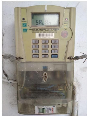
Meteran masih di bypass PLN
