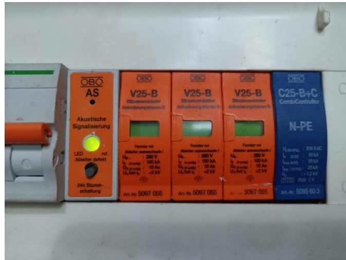
Gambar 4.2. Arrester pada panel Automatic Transfer Switch (ATS)
