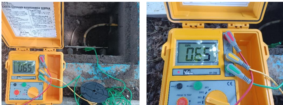
Tahanan pentanahan blok kontrol No. 6
