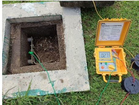
Tahanan pentanahan blok kontrol No. 2
