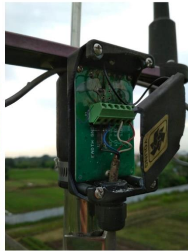
Box penutup wiring pecah
