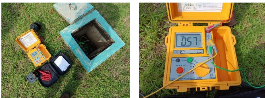
Gambar 4.25. Tahanan pentanahan blok kontrol No. 1
