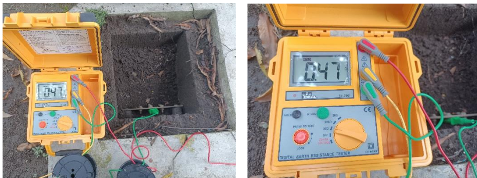
Tahanan pentanahan blok kontrol No. 7
