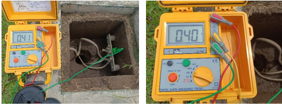
Tahanan pentanahan blok kontrol No. 5
