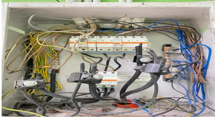
Gambar 2.13 Panel Pembagi plts dan pln
