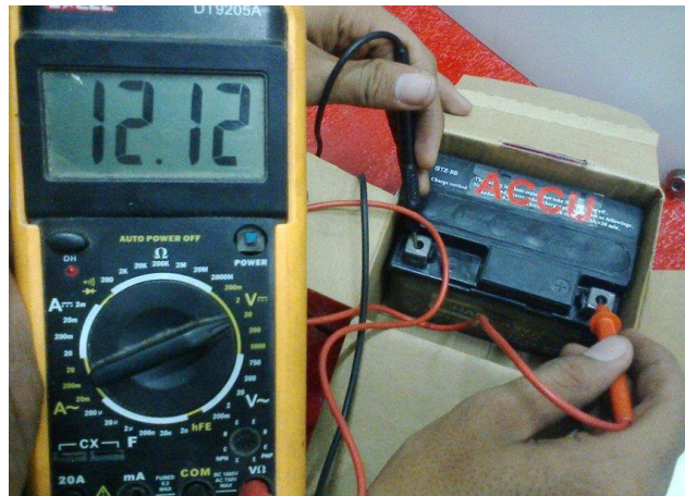
Gambar 4.3 Pengukuran tegangan pada Baterai yang disuplai oleh PLTS
