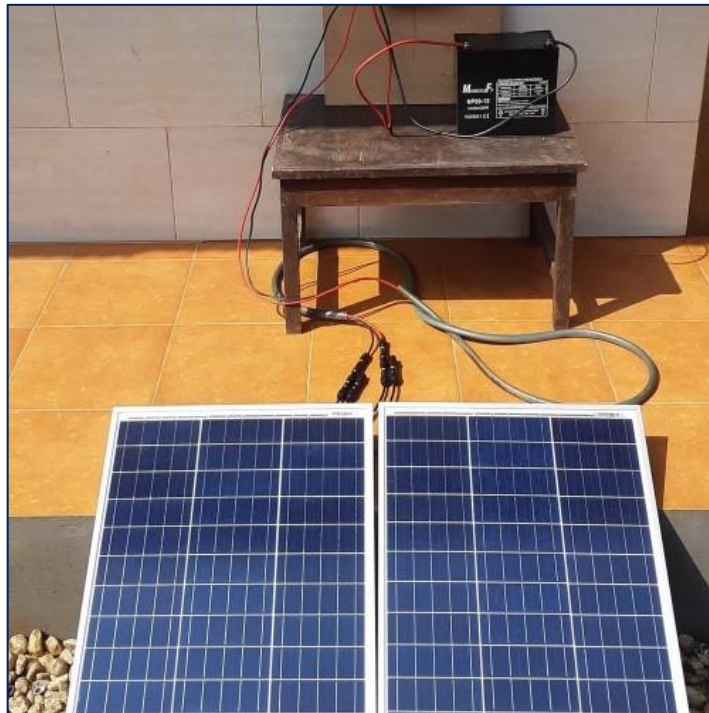
Gambar 4.2. PLTS yang digunakan
