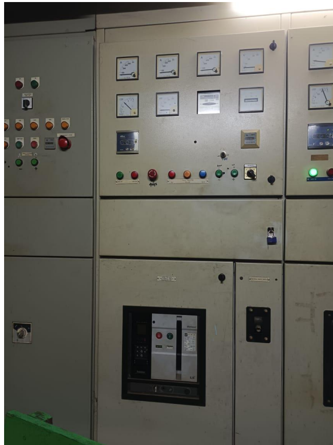
Gambar 2.4 Panel Kontrol Listrik
