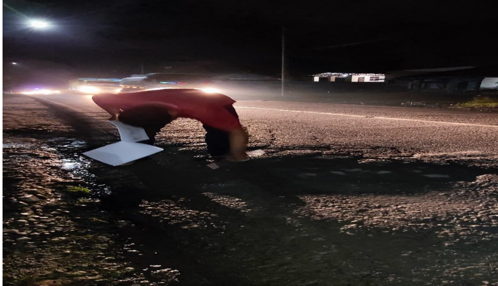
Gambar 4.4: Penurunan Bahu Jalan (Hasil Survei dilapangan)
