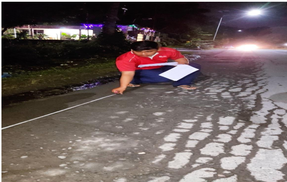
Gambar 4.5: Retak Memanjang dan Melintang (Hasil Survei dilapangan)
