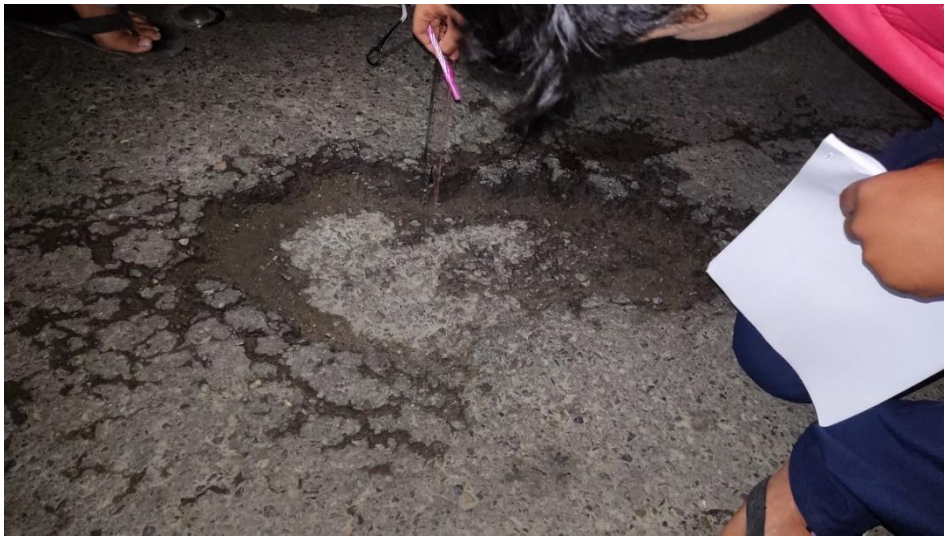
Gambar L.2: Foto Pengambilan Data Kerusakan
