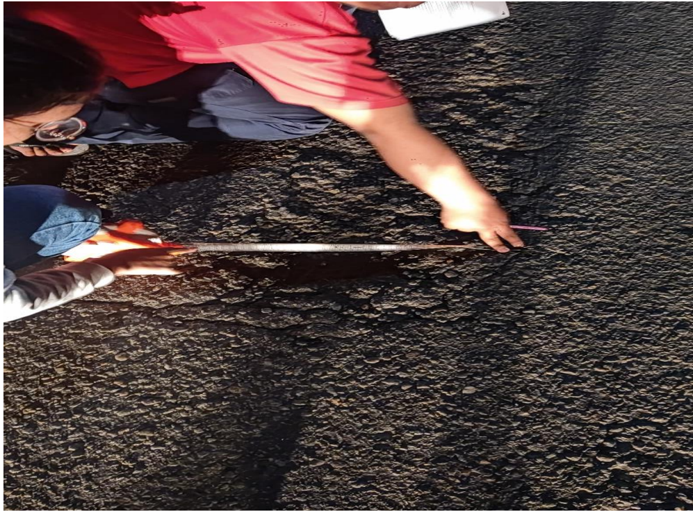
Gambar L.5: Foto Pengambilan Data Kerusakan
