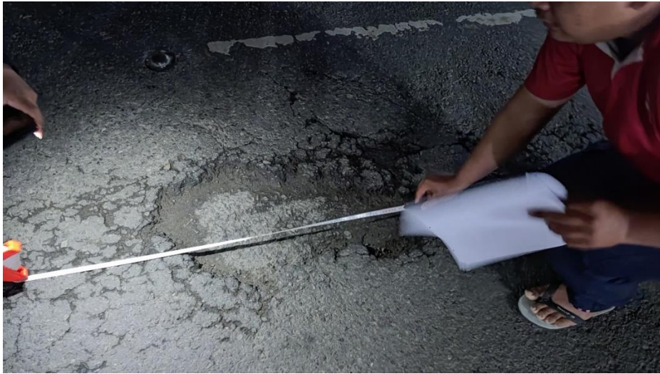
Gambar L.1: Foto Pengambilan Data Kerusakan
