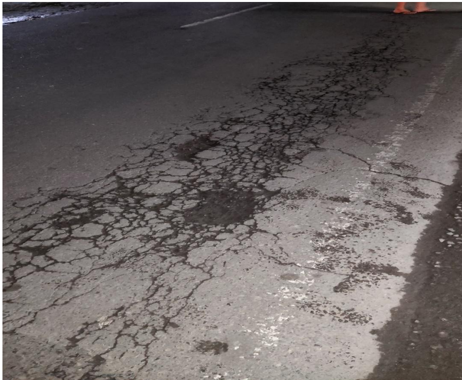
Gambar 4.1: Retak Buaya (Hasil Survei dilapangan)
