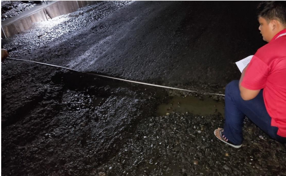
Gambar 4.3: Amblas (Hasil Survei dilapangan)
