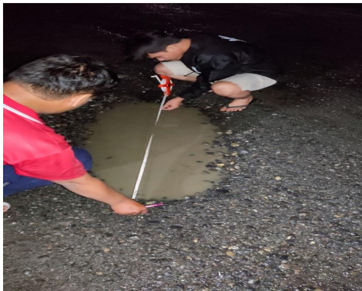
Gambar L.6: Foto Pengambilan Data Kerusakan
