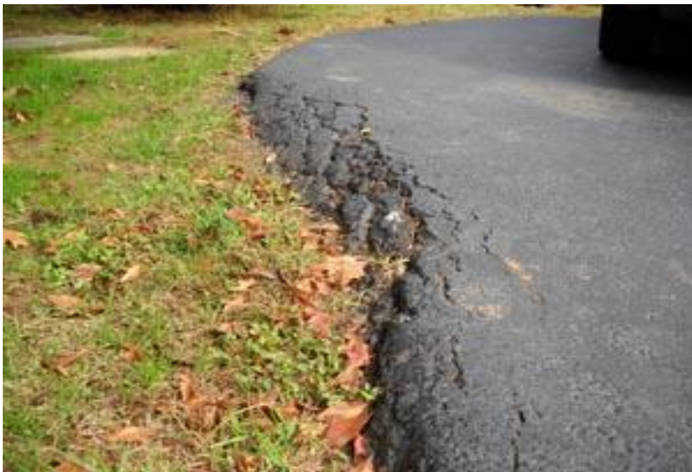
Gambar 2.11: Retak Pinggir/ edge cracking (google)
