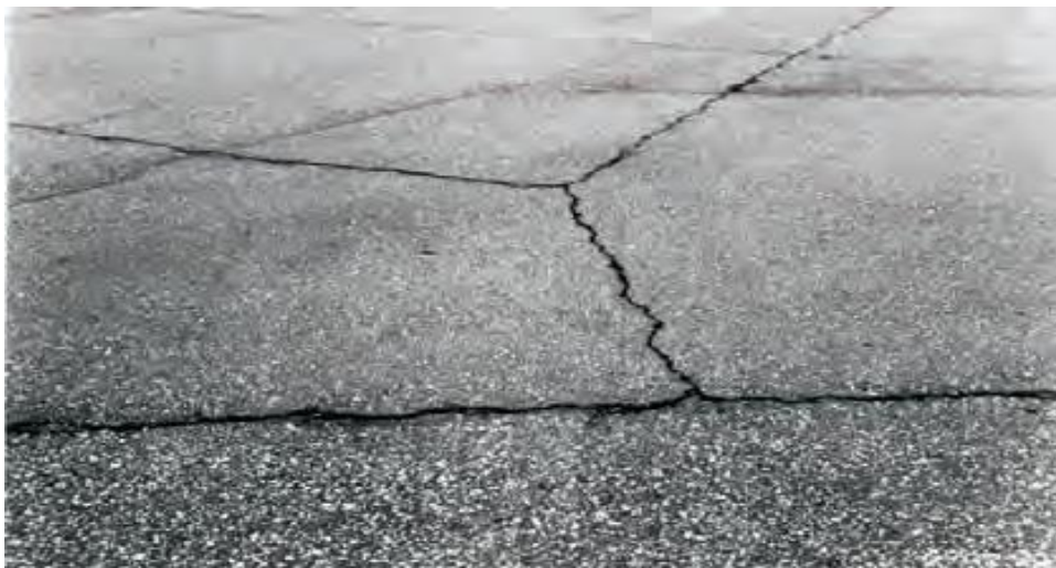
Gambar 2.7: retak kotak-kotak / block cracking (google)
