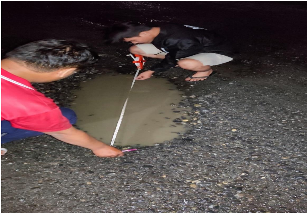
Gambar 4.7: Lubang (Hasil Survei dilapangan)
