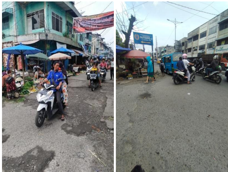
Gambar L.6: Kondisi Jalan di Simpang Pasar Palapa Brayan
