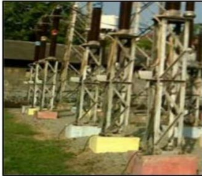
Gambar 2.16 Struktur Penyangga Arrester
