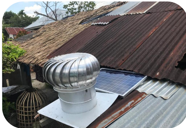
Gambar 4.12 Ventilator dan Panel Surya
