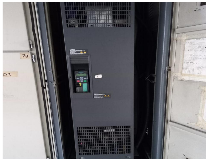
Gambar 3. 3 Inverter Siemens (Penulis, 2021)
