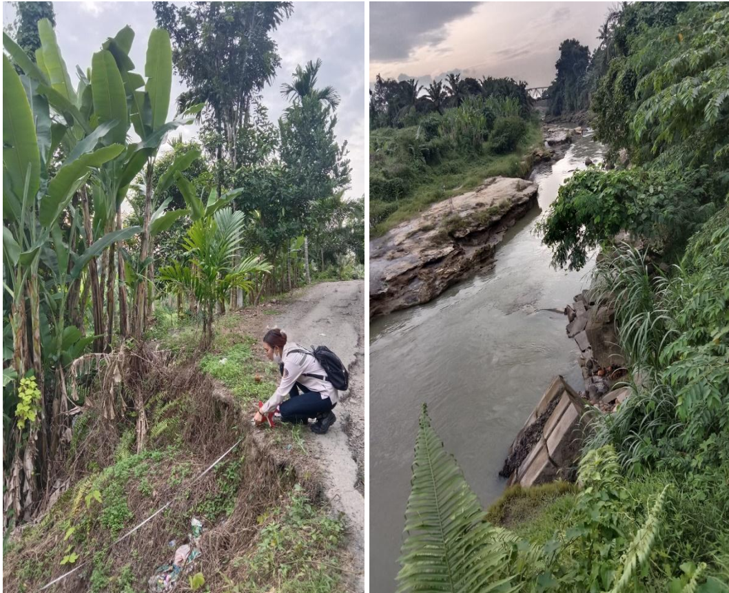
Gambar 4.2 Kondisi Tanah longsor Dan Penahan Dinding Tanah Yang Hancur
