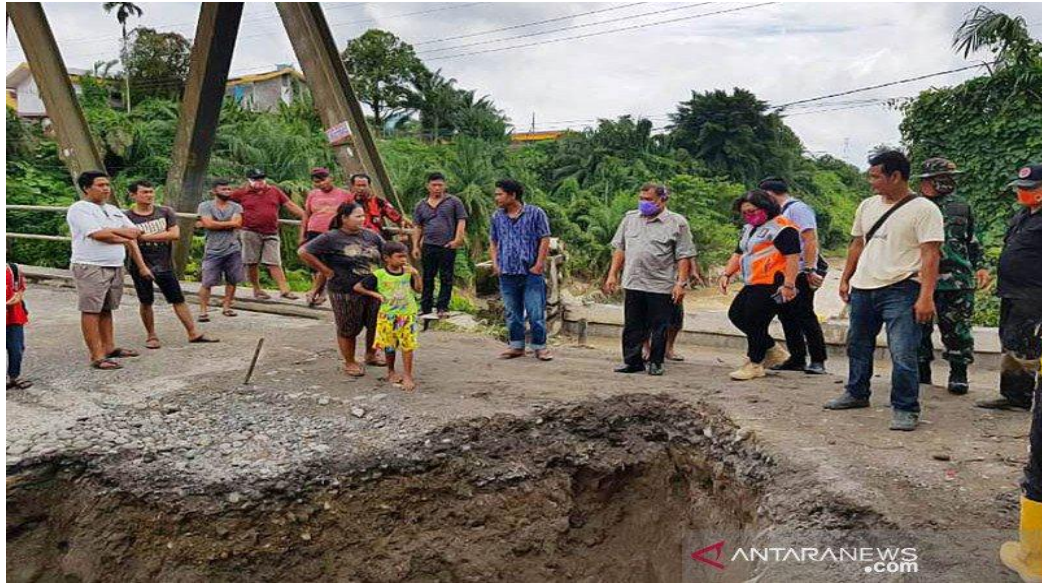
Gambar 2.3 Keadaan jembatan merah tuntungan deli serdang longsor.
