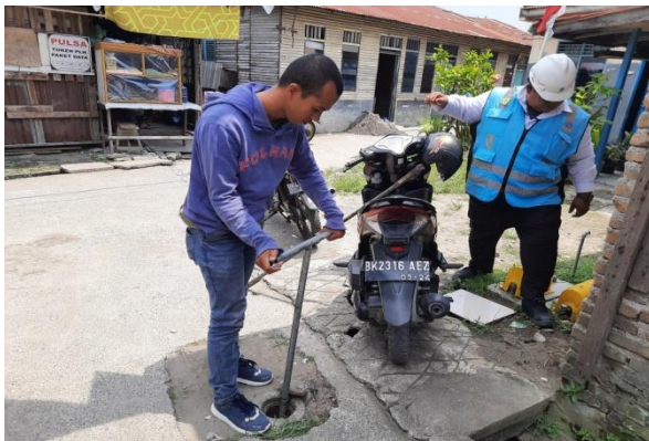
Melakukan pembersihan aliran pipa yang bocor
