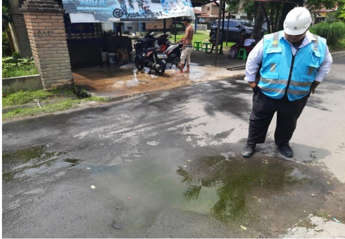
Adanya genangan air yang menandakan terjadinya kebocoran pipa
