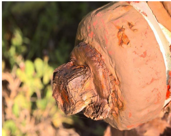
Gambar 2.7 Fatigue Corrosion ( korosi lelah )
