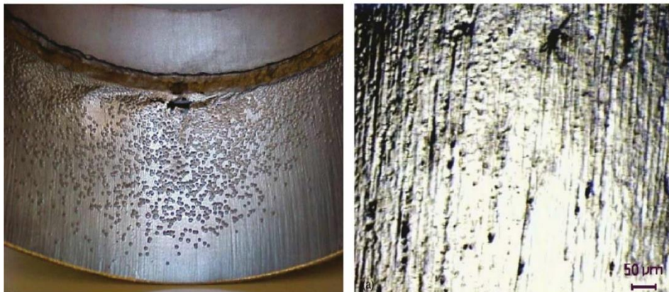
Gambar 2.3 Errosion Corrosion (Korosi Erosi) (Roshan Kuruvila. Dkk, 2018)
