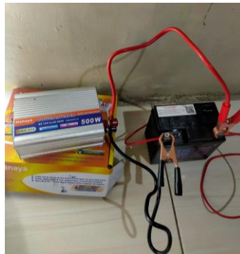
Gambar baterai terhubung dengan inverter
