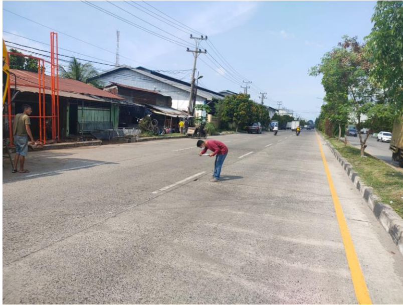
Gamabr L.5: Pengamatan Kerusakan Jalan
