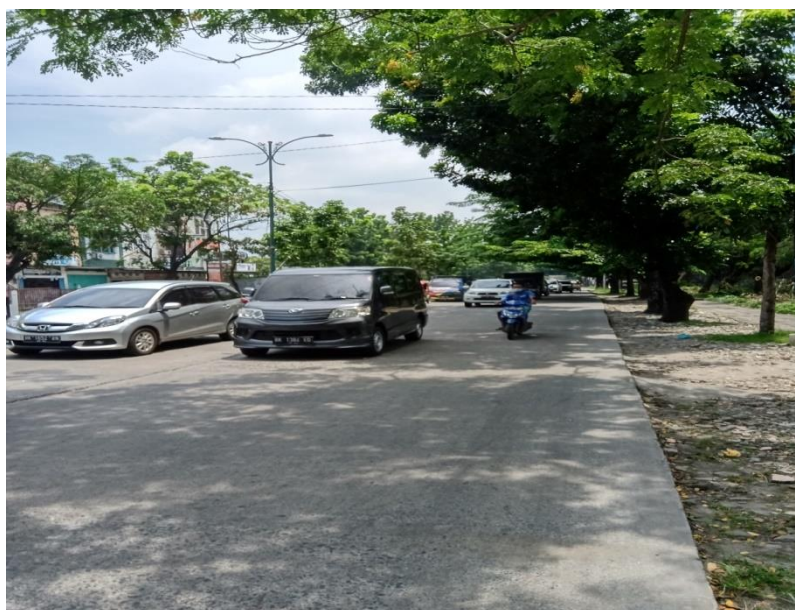
Gambar L.3: Kondisi Jalan Krakatau
