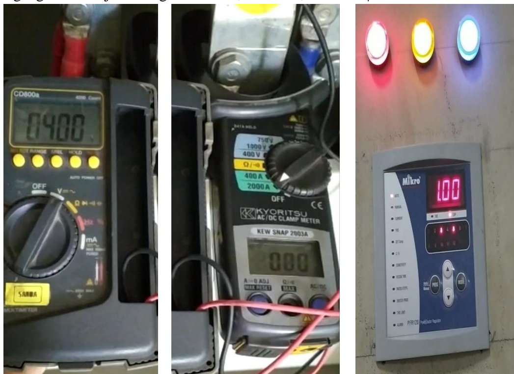
Gambar 4.6 Hasil percobaan II motor kompresor tipe G.A 250 KW menggunakan kapasitor pada posisi off
