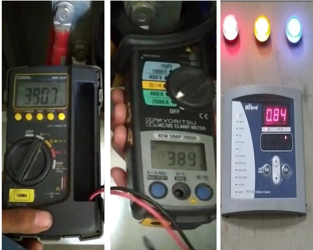
Gambar 4.4 Hasil percobaan motor kompresor tipe G.A 250 KW tanpa menggunakan kapasitor pada posisi Load atau sudah berbeban
