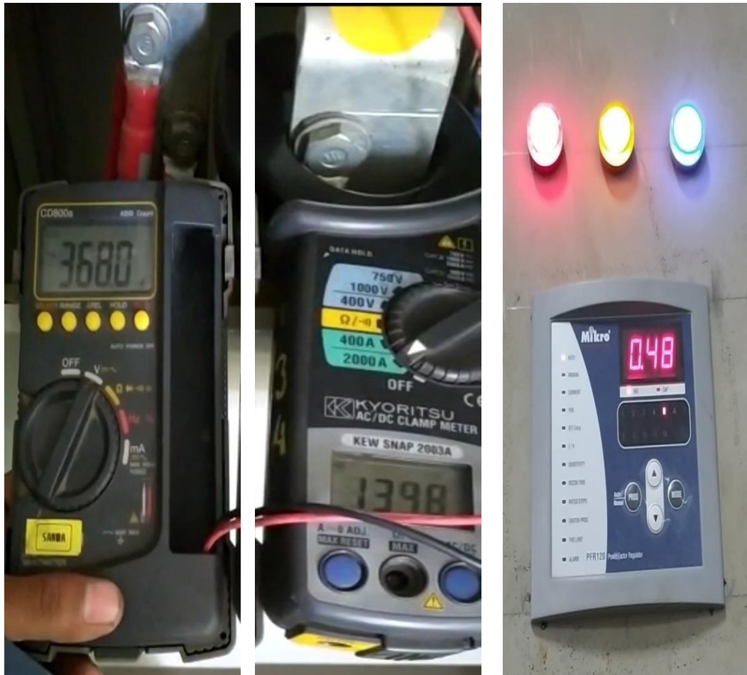
Gambar 4.2 Hasil percobaan motor kompresor tipe G.A 250 KW tanpa menggunakan kapasitorposisi Start awal
