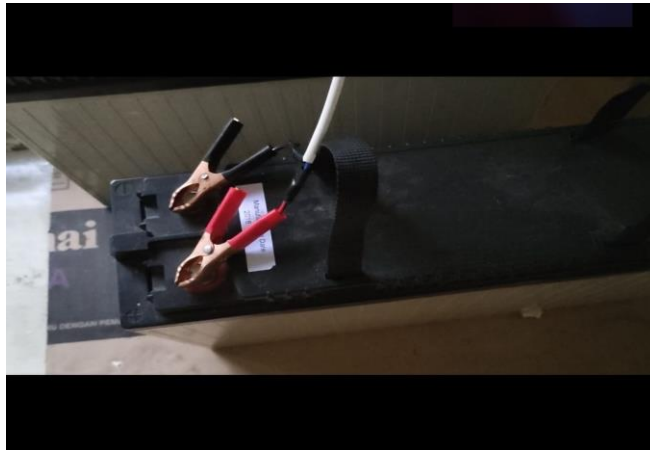
Gambar 3.17 Menghubungkan output charger controller ke baterai dc 3,5 Ah.
