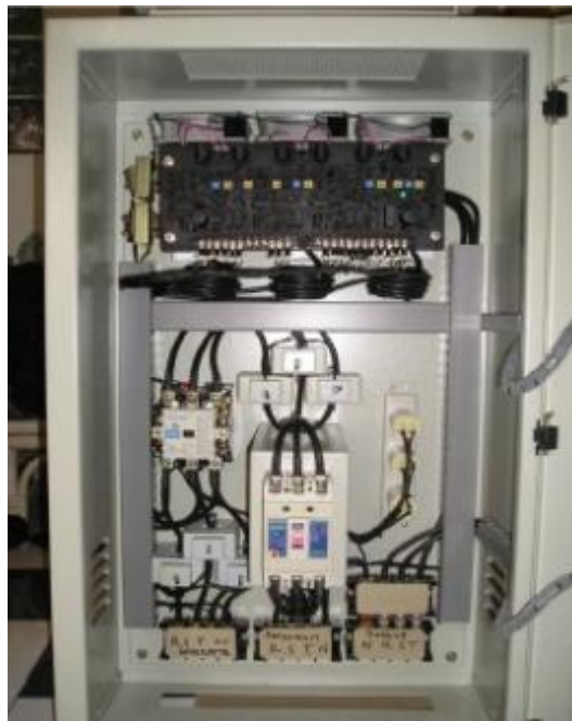
Gambar 2.22 Panel Sistem Kontrol
