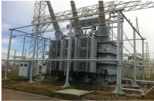
Gambar 2.1 Transformator step-down pada gardu induk PT. Inalum
