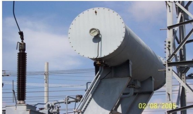
Gambar 2.8 Tangki pada transformator
