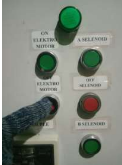
Gambar 4.11 Menekan push button off elektro motor.
