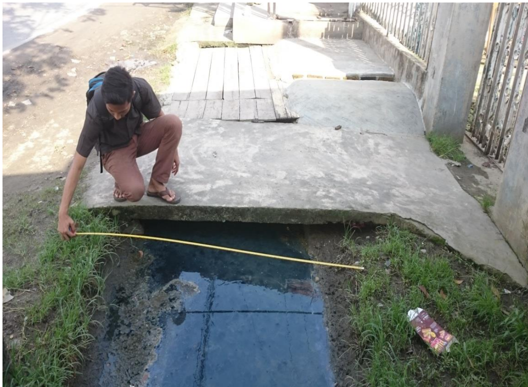
Kondisi drainase sekunder pada STO-11 jarak 1330 meter.
