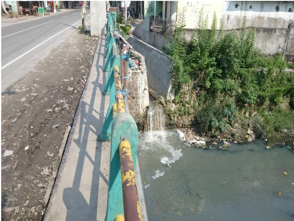
Gambar 3.3: Kondisi drainase primer pada Sp-1 jarak 447,5 meter.
