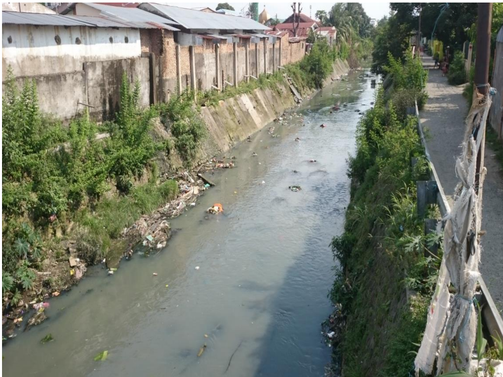
Gambar 3.4: Kondisi drainase primer pada Sp-4 jarak 1790 meter.
