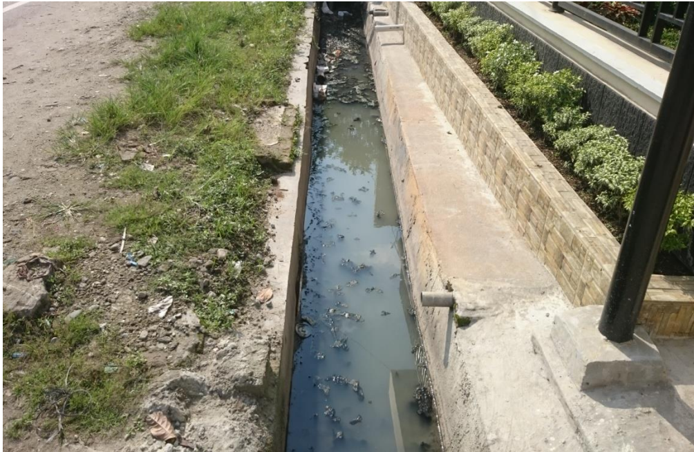
Gambar 3.5: Kondisi drainase sekunder pada Ss-2 jarak 665 meter (Kiri).
