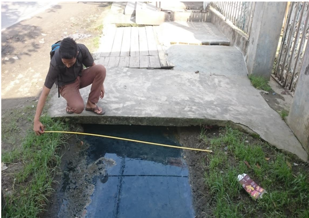
Gambar 3.8: Kondisi drainase sekunder pada Ss-3 jarak 997,5 meter (Kanan).
