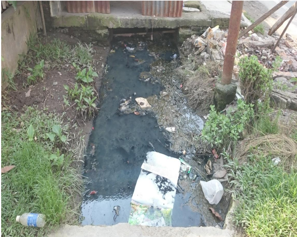
Gambar 3.7: Kondisi drainase sekunder pada Ss-4 jarak 997,5 meter (Kiri).
