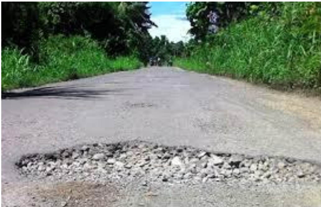
Gambar L.2: Tengah kerusakan jalan (Berlubang).
