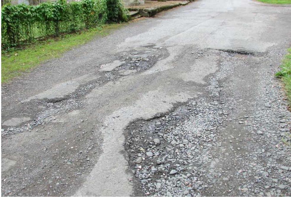
Gambar L.5: Pinggir kerusakan jalan (Amblas).
