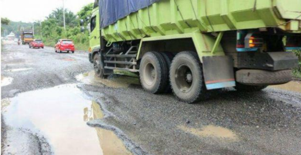
Gambar L.1: Pinggir kerusakan jalan (Berlubang).
