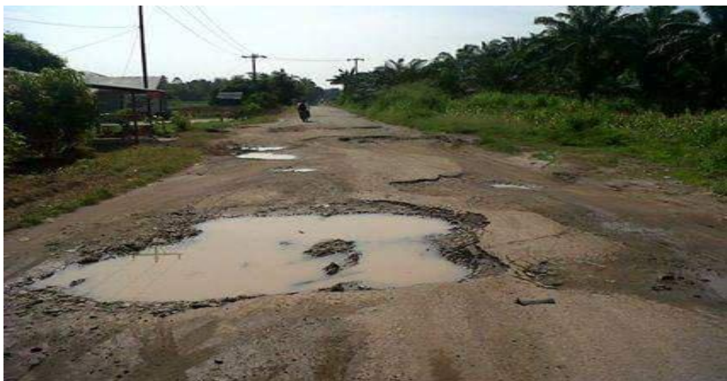
Gambar L.4: Pinggir dan tengah kerusakan jalan (Berlubang dan Ambblas).
