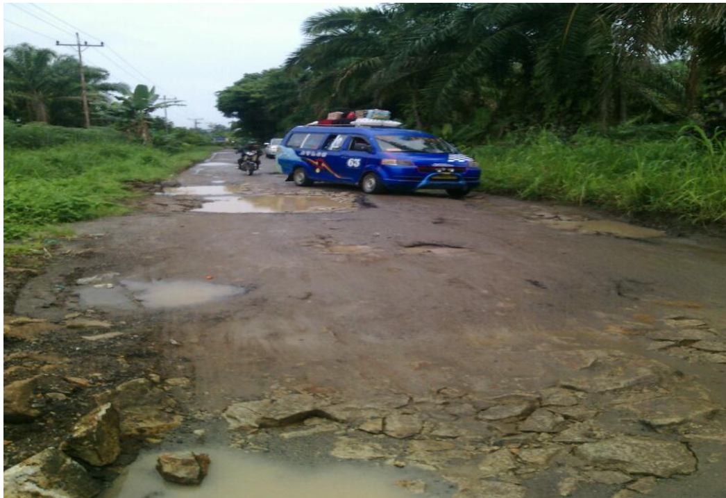
Gambar L.3: Pinggir dan tengah kerusakan jalan (Berlubang dan Retak).
