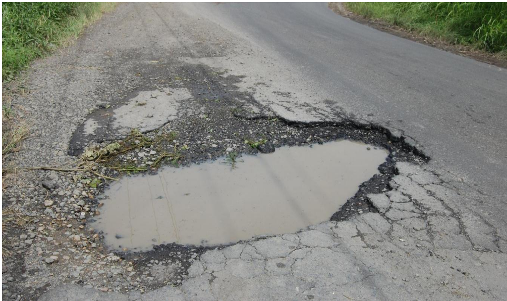
Gambar L.6: Pinggir kerusakan jalan (Belubang).
