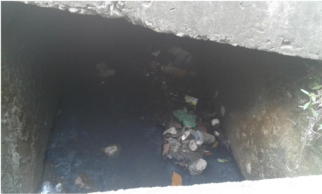
Gambar L.4: Kondisi saluran yang bersedimentasi tinggi
