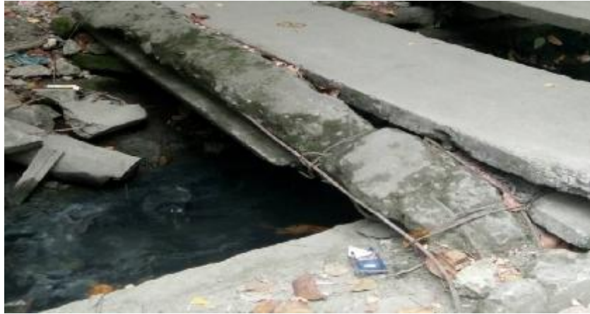
Gambar 3.4: Kondisi saluran drainase sebelah kiri di kawasan Jalan Jawa.
