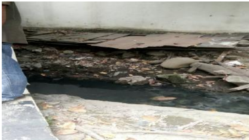
Gambar 3.5: Kondisi saluran drainase sebelah kiri di kawasan Jalan Jawa.
