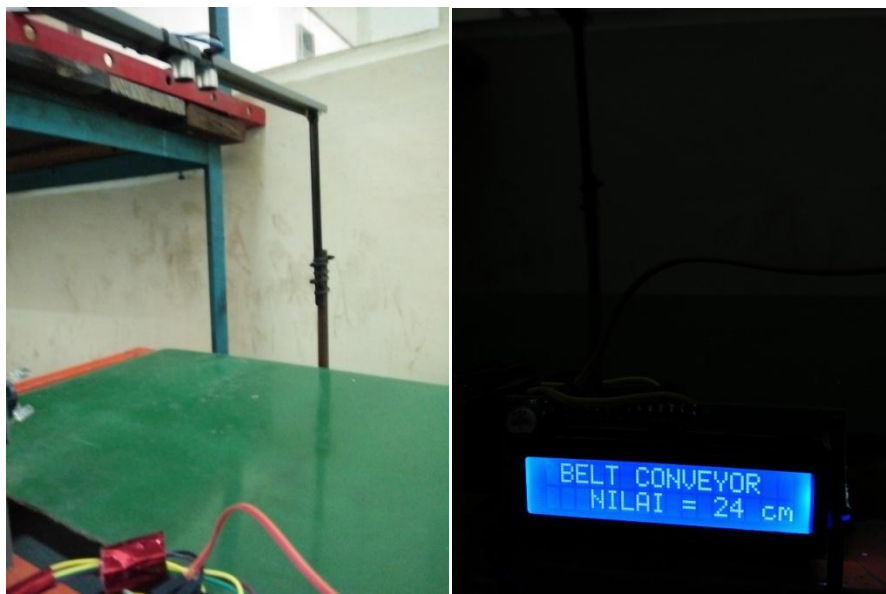
Gambar 4.1 Belt Conveyor di lengkapi Sensor Ultrasonik
