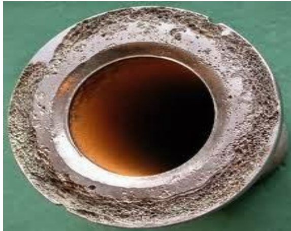
Gambar 2.4 Crevice Corrosion (Korosi Celah) pada sambungan pipa
