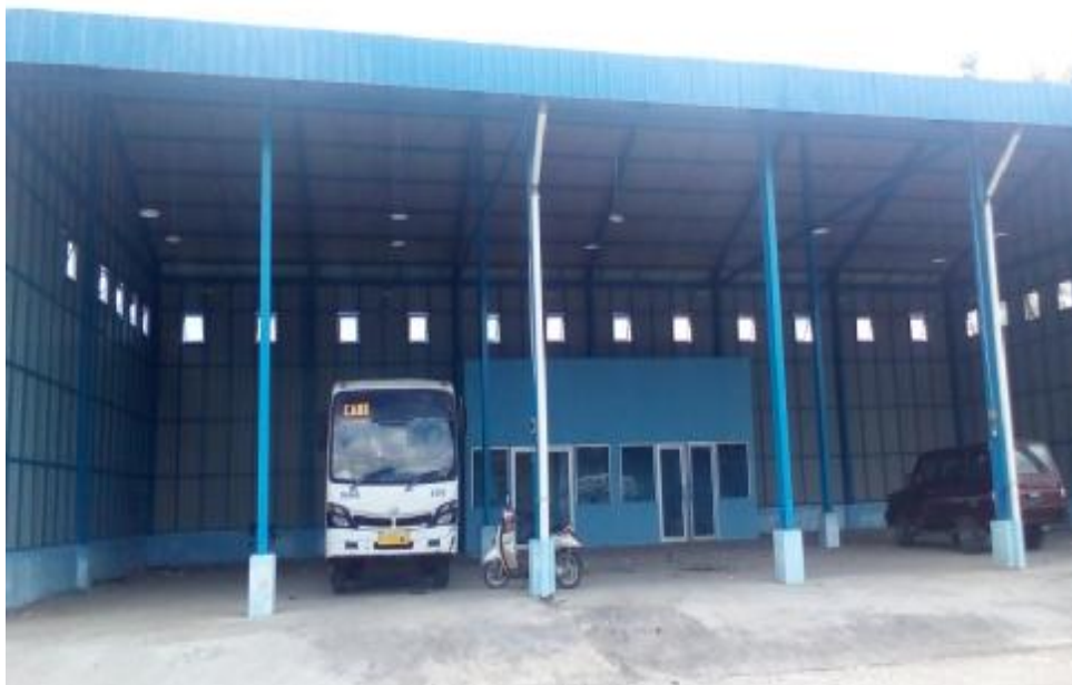
Gambar L. 10: Gudang Bongkar Muat Yang Tidak Berfungsi
