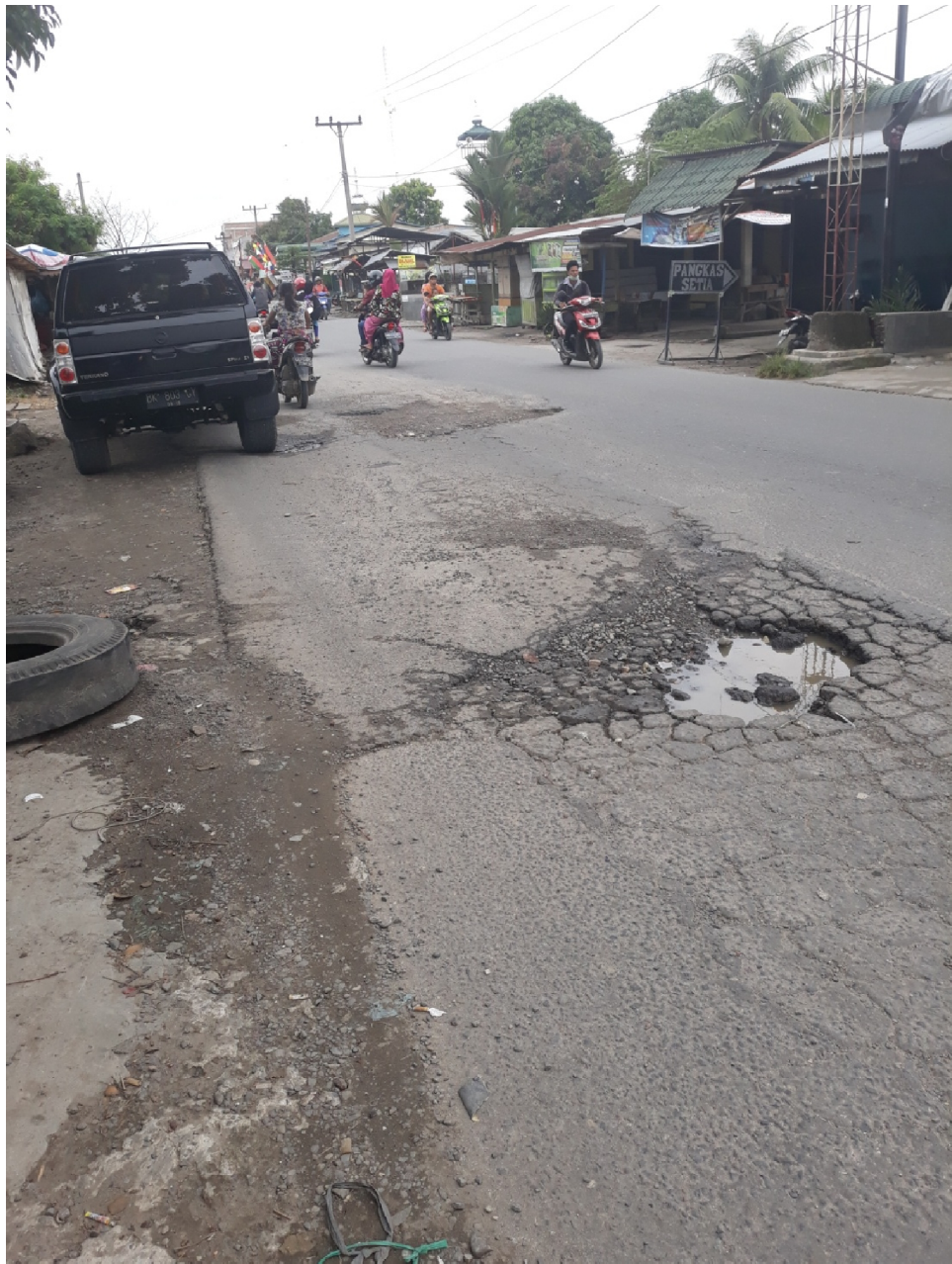
Gambar L 2: Jalan Metrologi raya yang rusak
