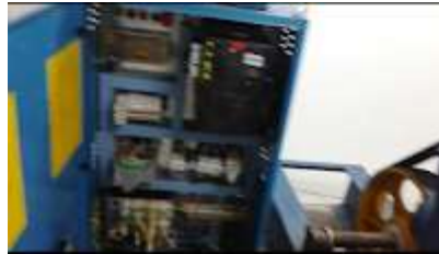
Gambar 3.5. Control System atau Control Panel
