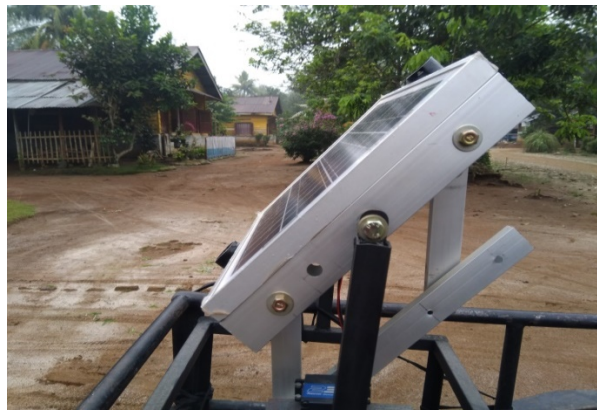
Gambar 4.9. Posisi panel surya pada pukul 08:00 WIB
