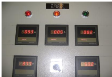
Gambar 4.1. Control panel daya terpasang untuk Arus, Tegangan dan Frekuensi pada Indikator
