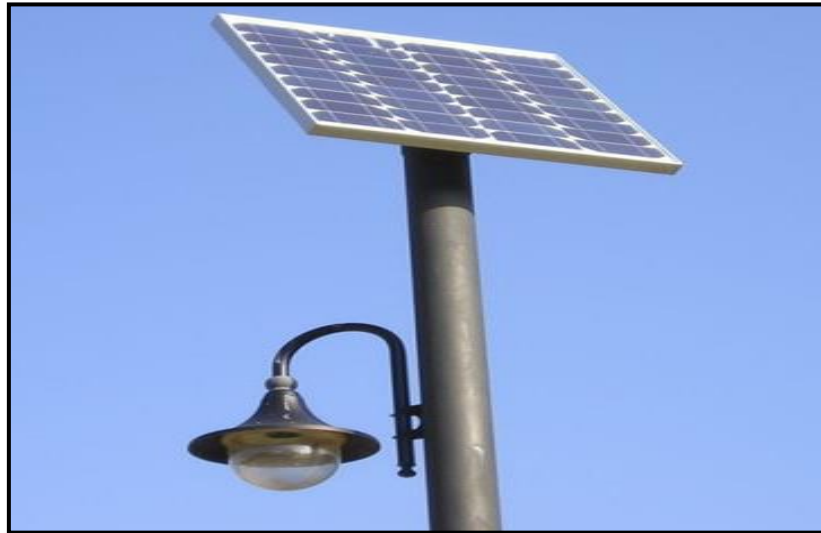
Gambar 2.13 Penerangan Jalan Umum Tenaga Surya (PJUTS)
