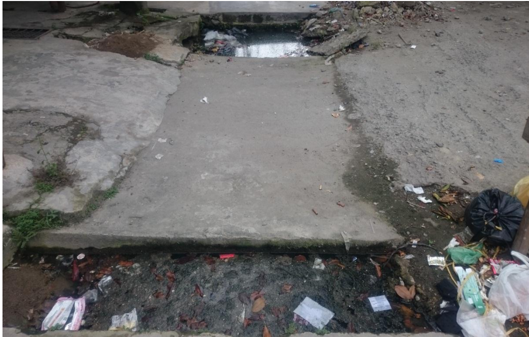
Gambar L.3: Kondisi drainase yang tidak mampu menampung debit air
