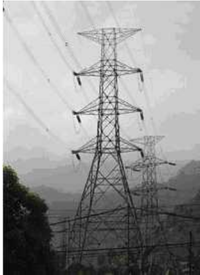
Gambar 4. Saluran Udara ( Overhead Lines )
