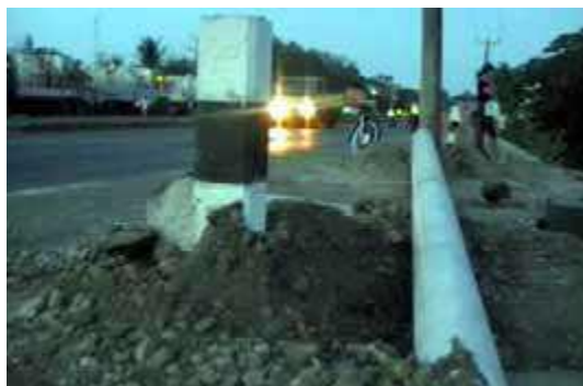
Gambar 5. Saluran Kabel Bawah Tanah ( UnderGround Cable )
