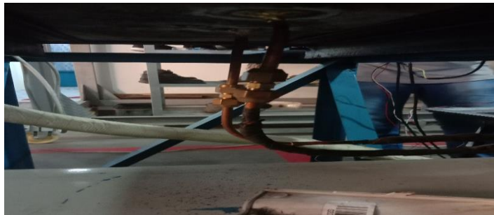
Gambar 4.36. Pipa Masuk Kondensor
