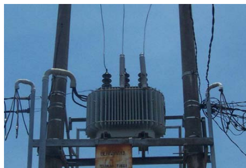
Gambar 2.23 Trafo Distribusi 200 KVA (Sumber: Julius Sentosa, dkk. 2006 )
