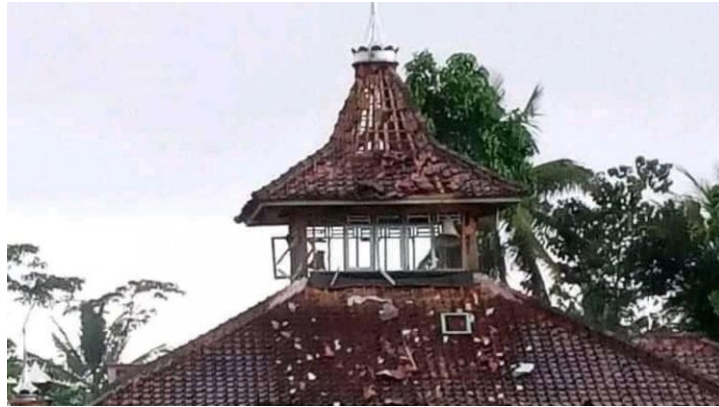
Gambar 2. 7 Kerusakan Bangunan Akibat Sambaran Petir
