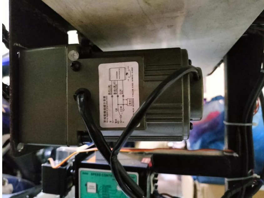
Gambar 2. 20 Motor Penggerak Conveyor
