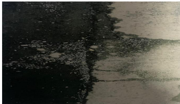
Gambar 3. 7 : Retak Memanjang Pada Ruas Jalan Perniagaan
