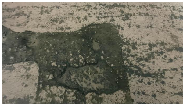
Gambar 3. 8 : Tambalan Pada Ruas Jalan Perniagaan
