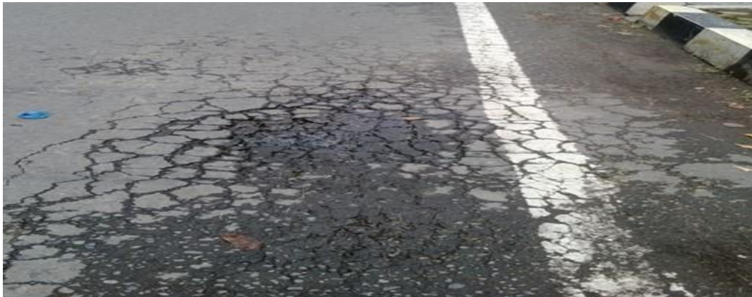
Gambar 2. 3: Retak kulit buaya (dpu.kulonprogokab n.d.)
