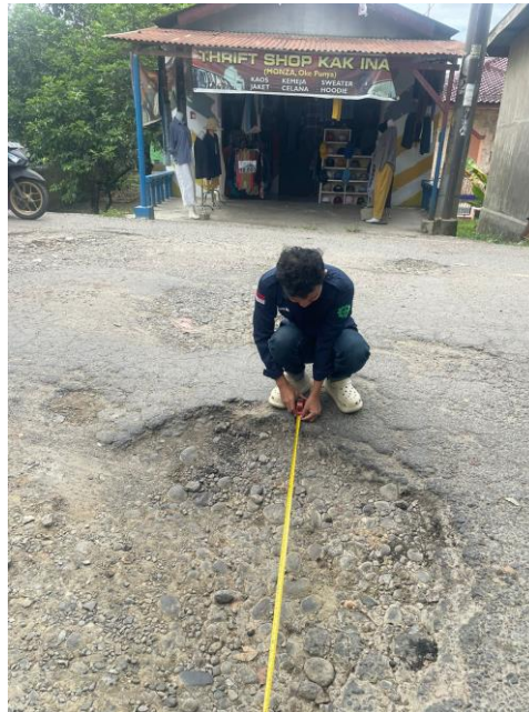
Gambar 1 : Pengukuran kerusakan Amblas pada segmen 0+100 s/d 0+200
