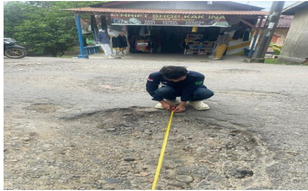
Gambar 3. 3 : Kerusakan Amblas Pada Ruas Jalan Perniagaan
