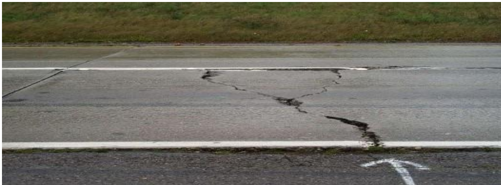
Gambar 2. 5 : Retak sambungan jalan (dpu.kulonprogokab n.d.)
