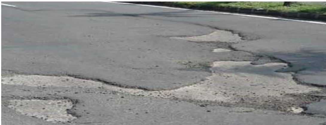
Gambar 2. 17 : Pengelupasan Lapisan Permukaan (Stripping) (dpu.kulonprogokab n.d.)
