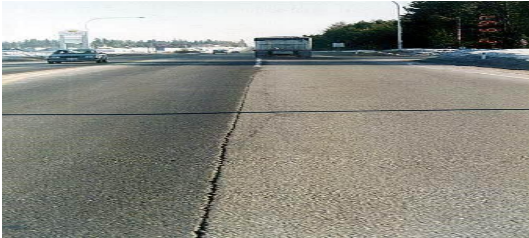
Gambar 2. 6 : Retak Sambungan Pelebaran Jalan (dpu.kulonprogokab n.d.)
