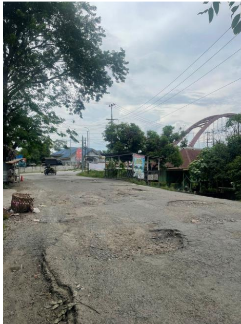
Gambar 4 : Kondisi permukaan Jalan pada Ruas Jalan Perniagaan
