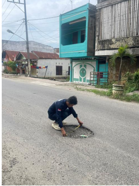
Gambar 3 : Pengukuran Kerusakan Lubang pada segmen 0+200 s/d 0+300
