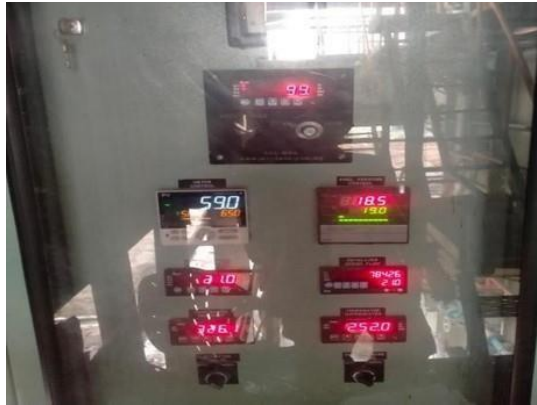
Gambar 3.10 Panel Parameter boiler
