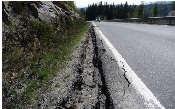
Gambar 2.8 : Kerusakan pinggir/retak pecah ( edge cracks/edge breaks ) (Hardiyatmo, 2015).
