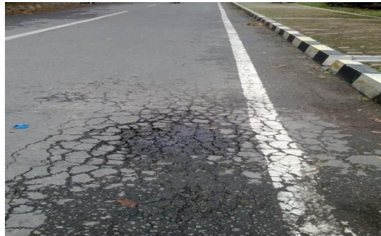
Gambar 2.6: Kerusakan retak kulit buaya ( alligator cracks ) (Hardiyatmo,2015).
