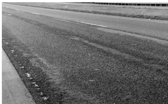
Gambar 2.10: Kerusakan pelapukan dan butiran lepas ( weathering and raveling ) (Hardiyatmo, 2015).
