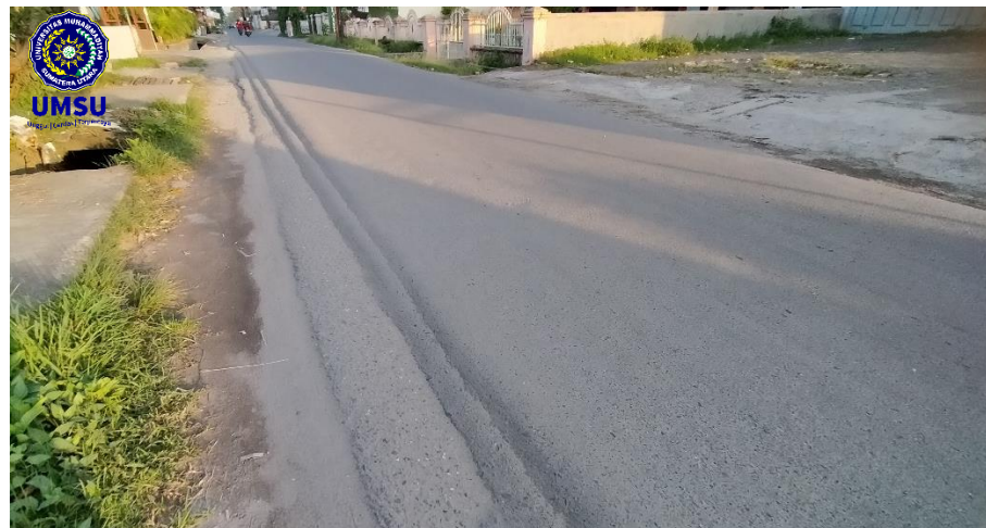
Gambar 4.1 Retak Memanjang di Lokasi Penelitian Sumber : Survei Lokasi (2023)
