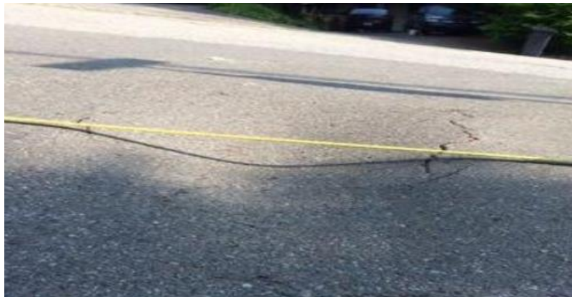
Gambar 2.9. Kerusakan Amblas ( Grade Depression ) Sumber : Dinas PUPR Kulonprogo (2021)
