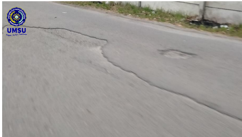
Gambar 4.5 Pengelupasan Lapisan Permukaan ( Stripping ) Sumber : Survei Lokasi (2023)
