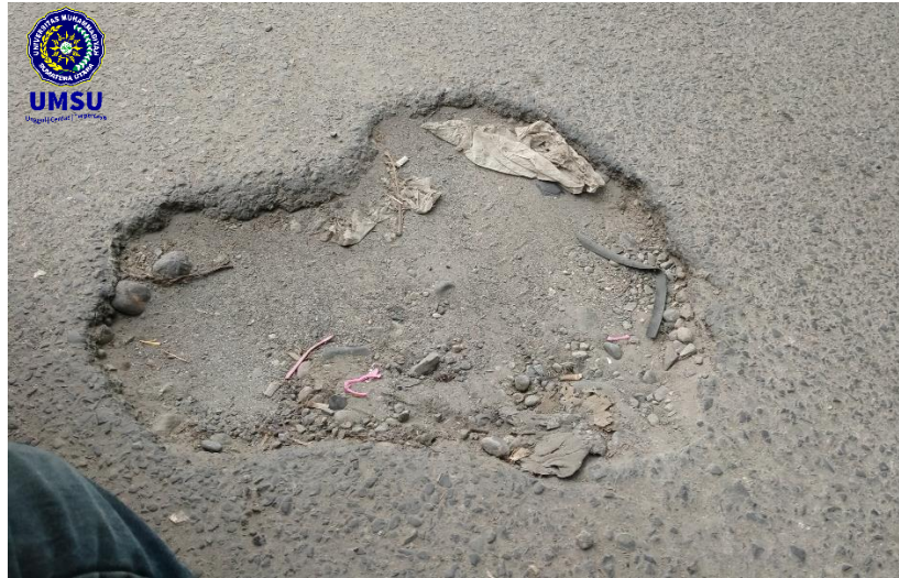
Gambar 4.3 Kerusakan Lubang di Lokasi Penelitian Sumber : Survei Lokasi (2023)
