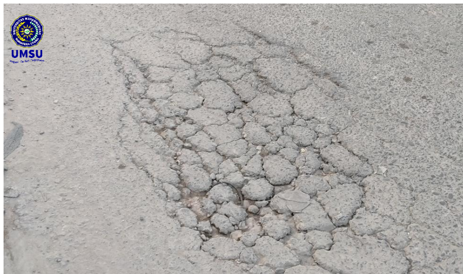
Gambar 4.2 Retak Buaya di Lokasi Penelitian
