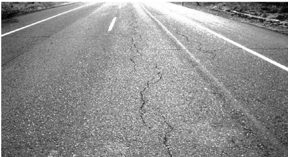
Gambar 2.1. Retak Memanjang Sumber : Dinas PUPR Kulonprogo (2021)
