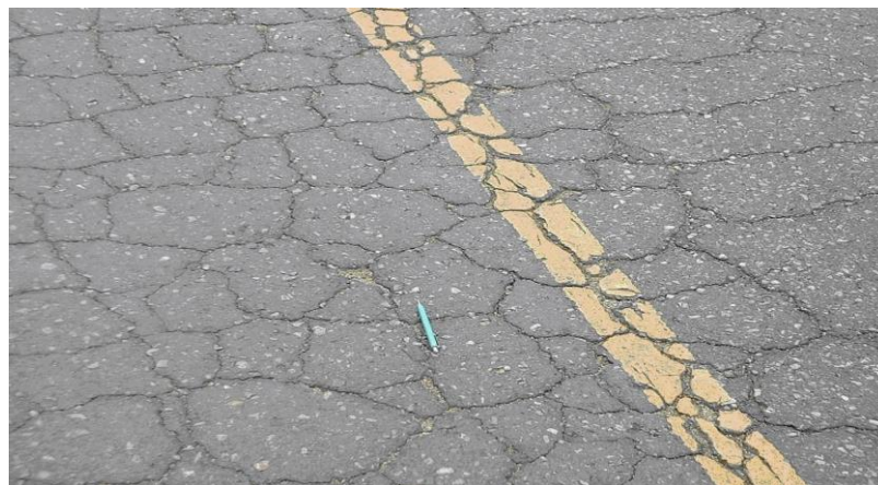
Gambar 2.5. Retak Kulit Buaya Sumber : Dinas PUPR Kulonprogo (2021)
