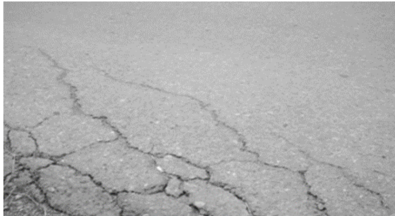
Gambar 2.4. Retak Tepi Sumber : Dinas PUPR Kulonprogo (2021)
