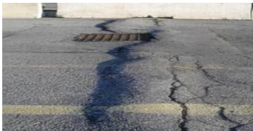
Gambar 2.10. Kerusakan Jembul Sumber : Dinas PUPR Kulonprogo (2021)
