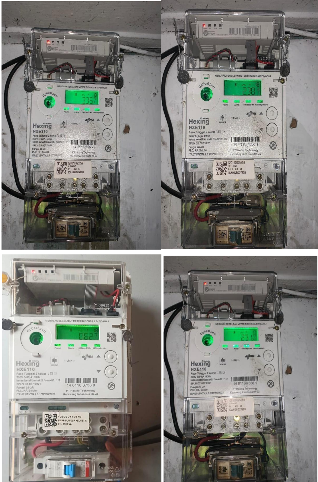
Gambar 4. 8 Pengukuran Arus dan Tegangan KWH AMR
